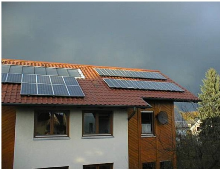
Anlage Solec, Foto: Stemberg Solar- und Gebäudetechnik. Diese PV-Anlage gewann den Sonderpreis als älteste Anlage des Fotowettbewerbs.
